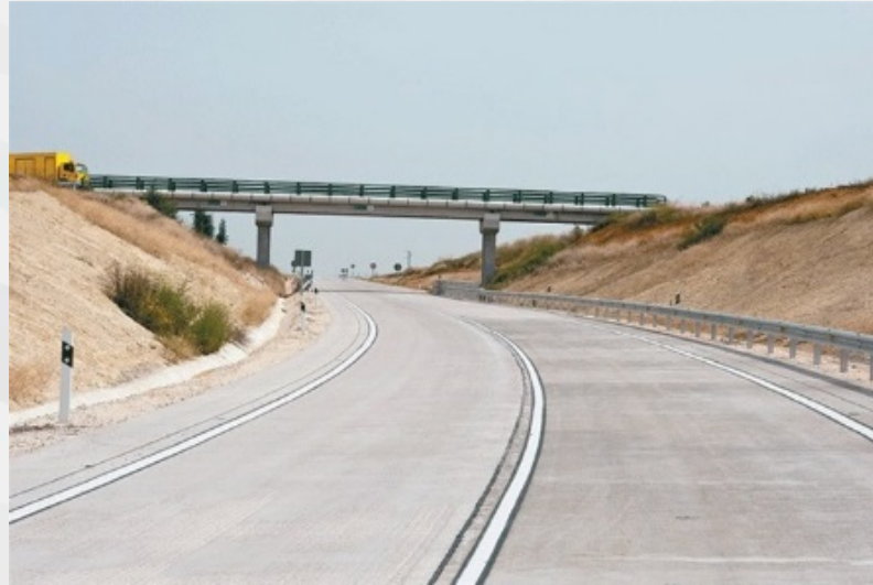
Superficie de concreto
