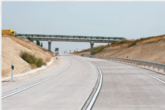
Superficie de concreto
