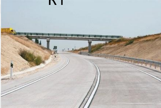
Superficie de concreto
